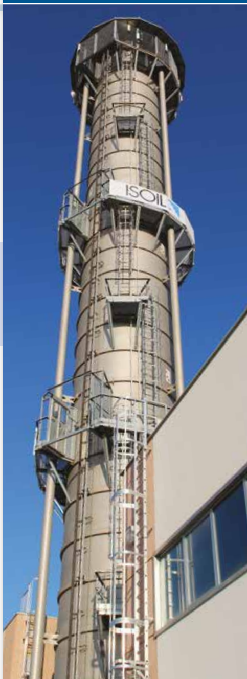
Il torrino piezometrico in acciaio inossidabile per la taratura dei misuratori
